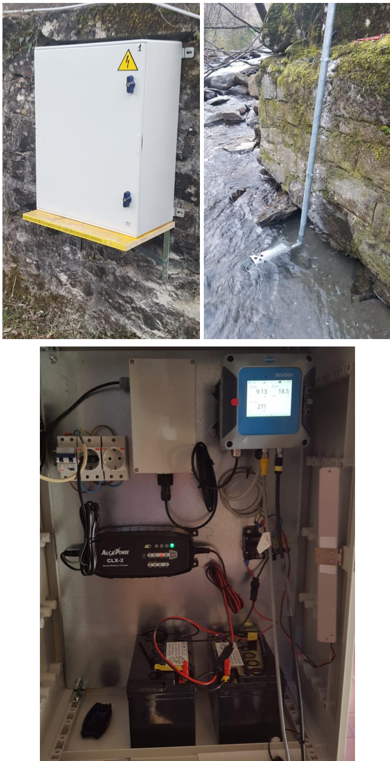
Figura 3-1: armadio alloggiamento strumentazione (sopra a sx), posizionamento sensori in alveo (sopra a dx), strumentazione all'interno dell'armadio (sotto)
